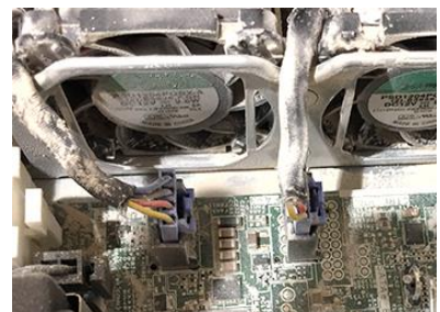
Baustaub in Lüftern
